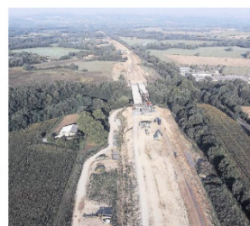
Les opposants demandent l'arrêt du chantier de l'A69 pourtant déjà bien avancé. / Crédit Atosca
